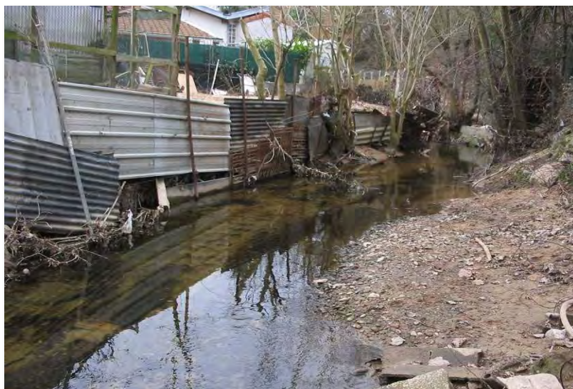
Un exemple manifeste de dégradation de berge Renforcement anarchique à l'aide de matériaux de récupération
